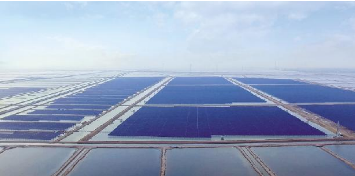
通威山东沾化“渔光一体”电站
