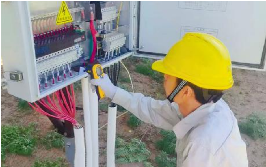
内蒙古敖汉光伏电站运维人员巡检设备
